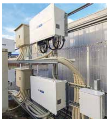
オムロン製のパワコン
